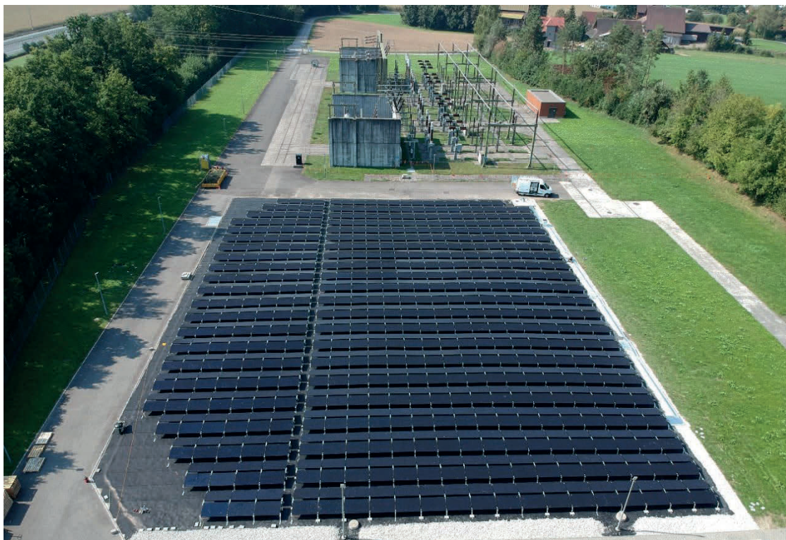
Abb.1: Solaranlage beim Umspannwerk Altgass in Baar. Quelle: https://www.axpo.com/ch/de/ueber-uns/medien-und-politik/medienmitteilungen.detail.html/medienmitteilungen/2020/Axpo-baut-Solaranlage-im-Kanton-Zug.html
